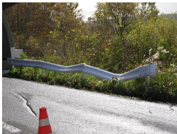
図13 ガードレールの損傷
