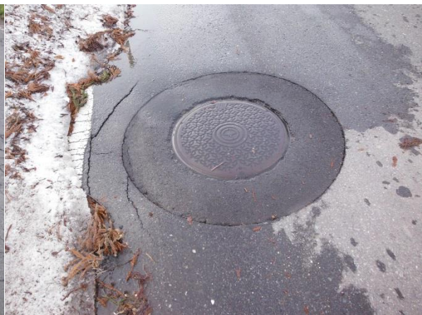
図 10 舗装補修後の亀裂
