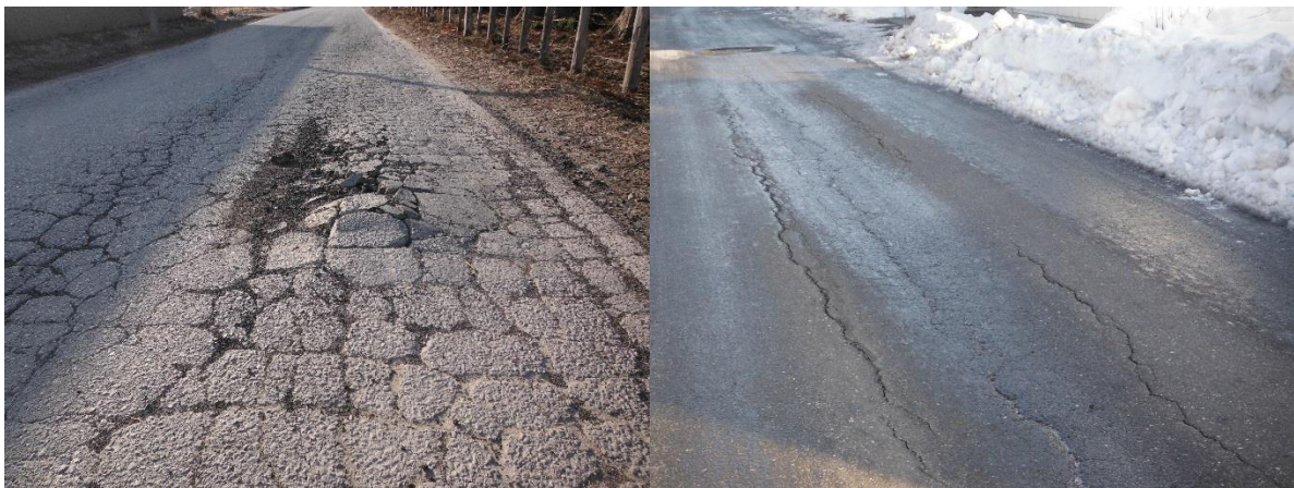
図5 舗装道路の亀裂①
