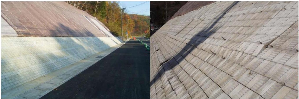
図4 切土斜面の変状
