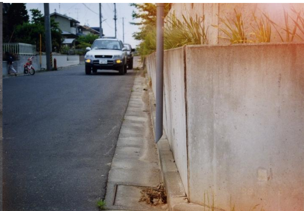
図2 プレキャストL型擁壁の変状
