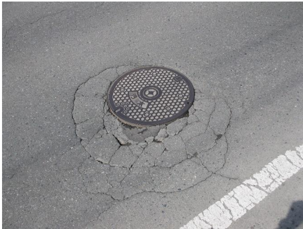
図 11 マンホール回りの亀裂
