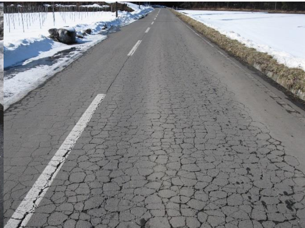
図 8 舗装道路の亀裂③
