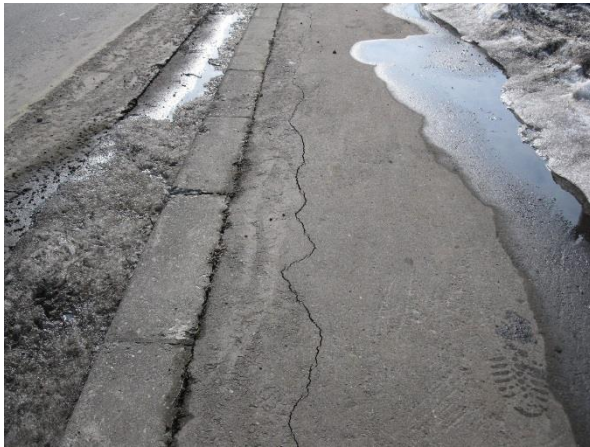
図 7 凍上による歩道舗装面の亀裂
