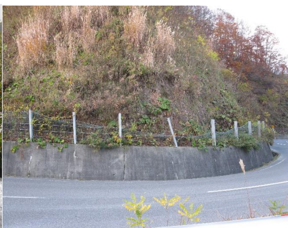
図14 防護柵の損傷
