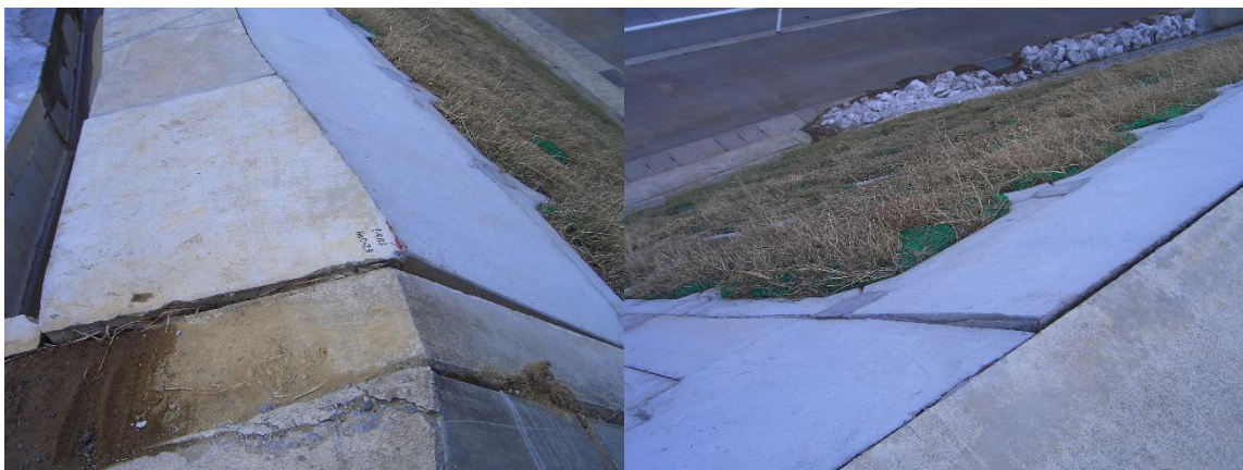
図3 法面保護工の変状
