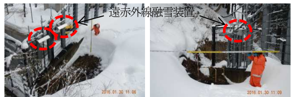
写真3 融雪状況 (1) 写真4 融雪状況 (2)
