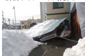
図 6 甲府市駐車施設倒壊
