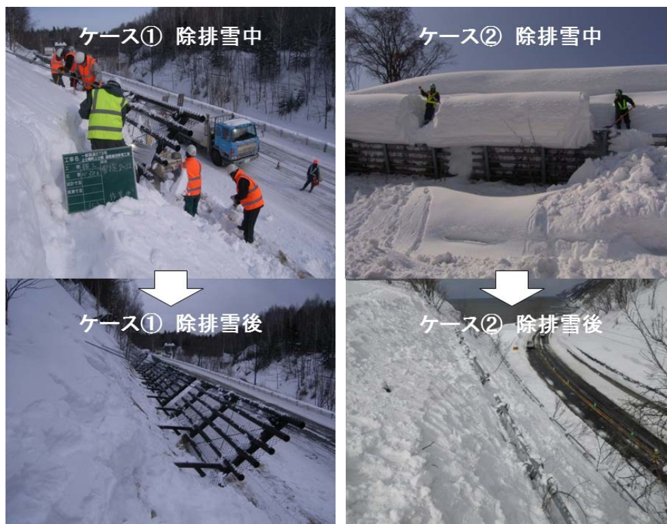
図2 雪崩予防柵の設置箇所における法面除排雪の事例
