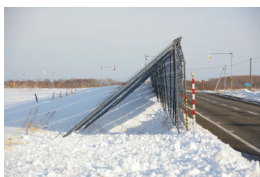
写真 10 下部間隙の閉塞した事例 (R44 浜中町 姉別付近)
