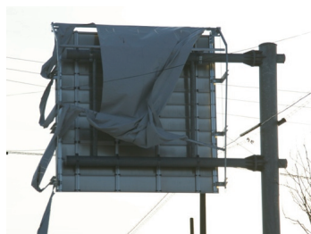
写真 5 強風による 着雪防止柵の破損 (R44 根室市厚床)
