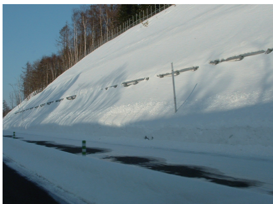
写真3 雪に埋もれる前の雪崩柵
