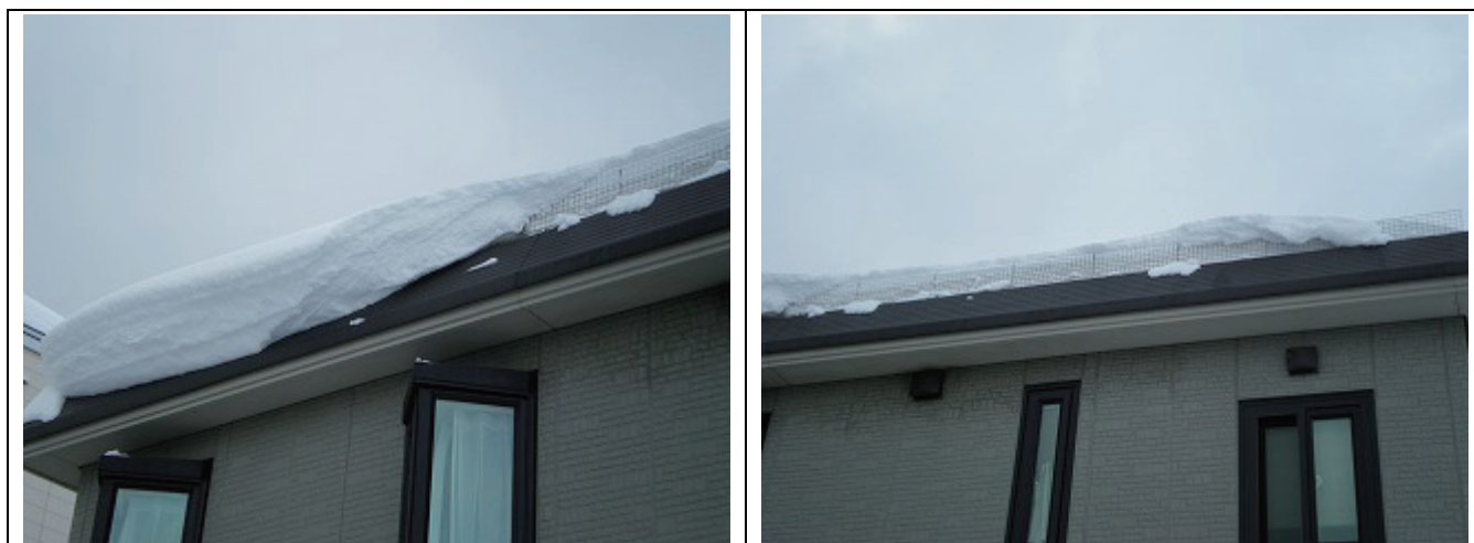
写真 6 屋根雪の雪庇状況 (2008 年 2 月 17 日 16:00 頃)
