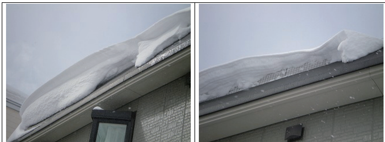
写真 5 屋根の雪庇状況 (2008 年 2 月 16 日 12:30 頃)
