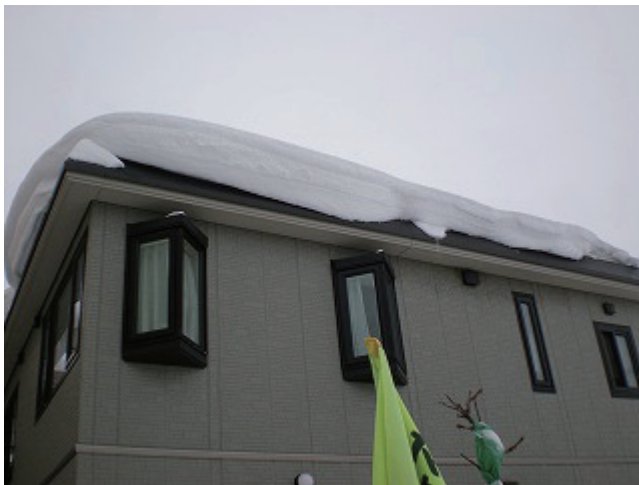
写真 1 無落雪住宅の屋根に形成する雪庇
