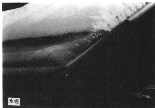
写真2 軒先に形成された氷堤の状況
